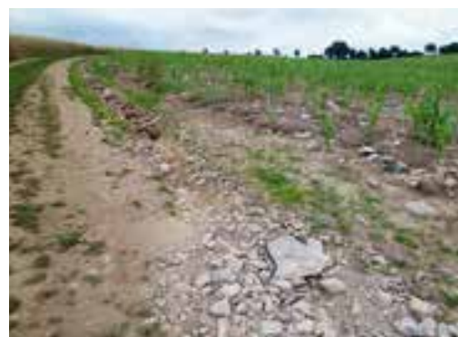
links: Erosion am Übergang zum Steilhang, Westlich der Somsdorfer Höhe an der Hangkante, Erosionsrinne zur Wilden Weißeritz. Foto: Ernst Ulrich Köpf, 11. Juli 2013
