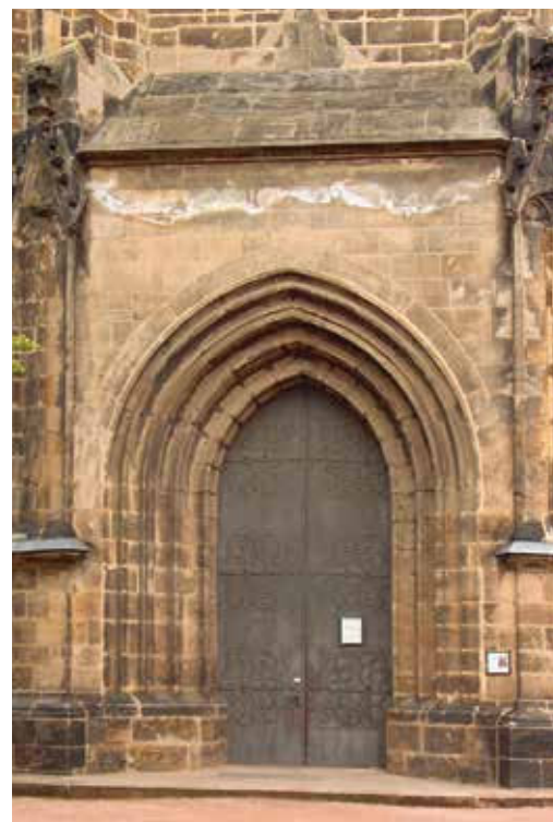
Westportal der Fürstenkapelle am Meißner Dom mit Salzausblühungen unterhalb des Traufgesimses, Ansicht vom Domplatz, Zustand 2005.
